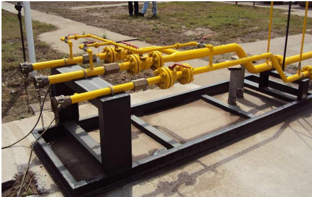
Figura 26. Estación de recibo de propano líquido
