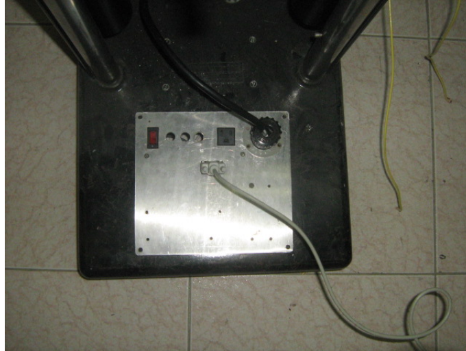
Figura 55. Conexión del control de temperatura
