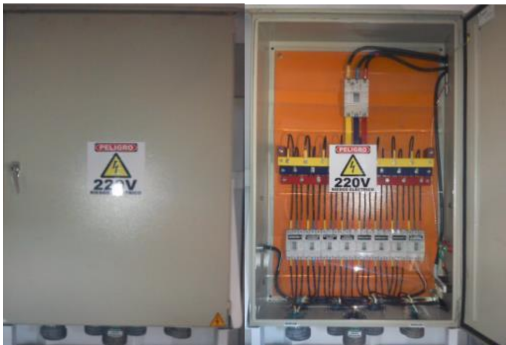
Figura 26: Tablero eléctrico de 220V
