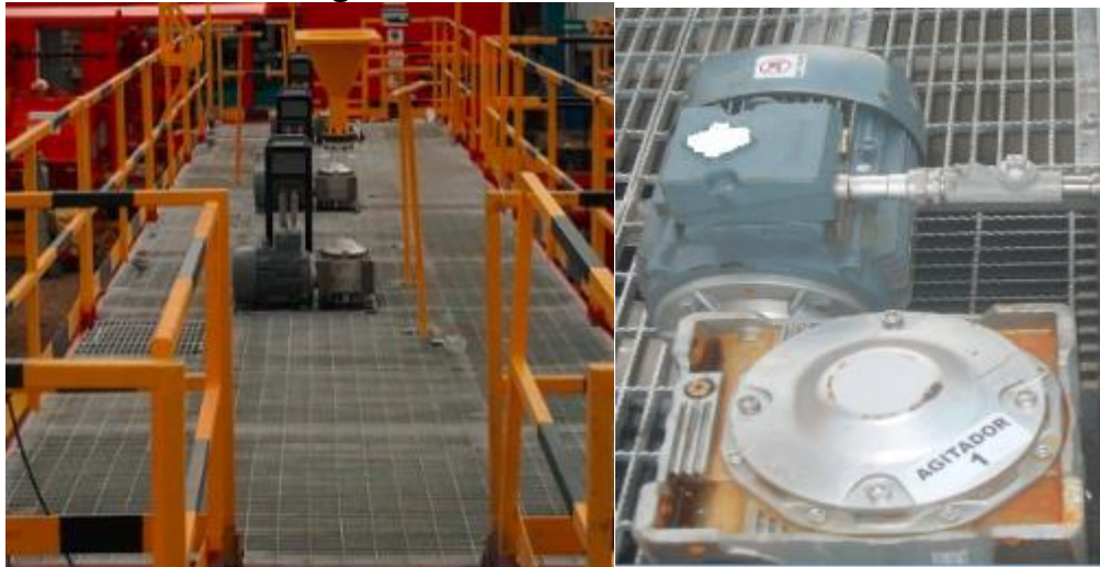
Figura 29: Motor eléctrico de 7.5 HP
