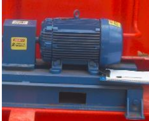
Figura 30: Motor eléctrico de 40 HP
