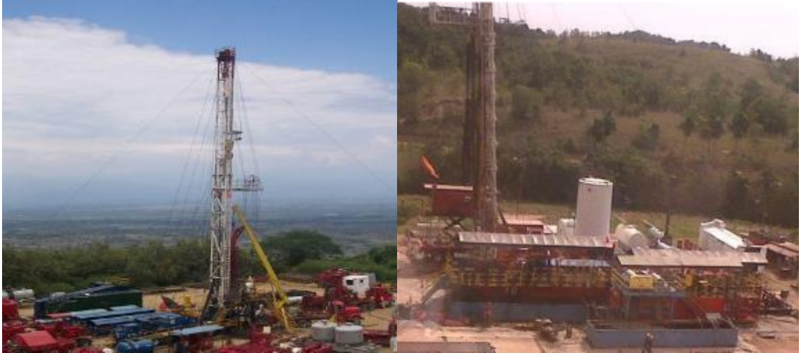
Figura 3. Equipos de Workover
