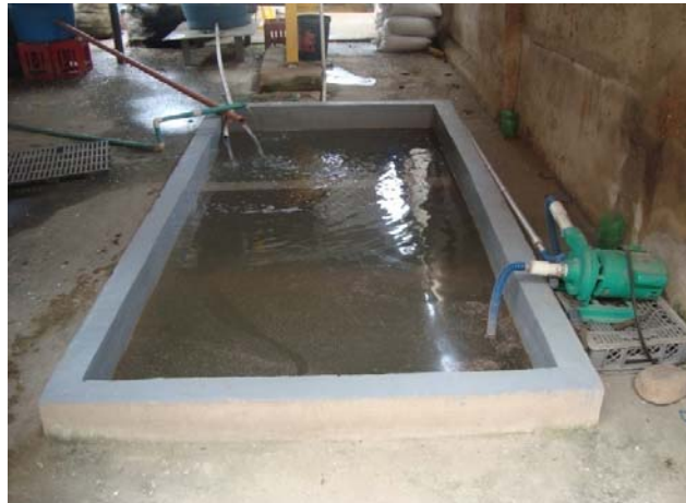
Foto 23. Pileta para la reutilización del agua
