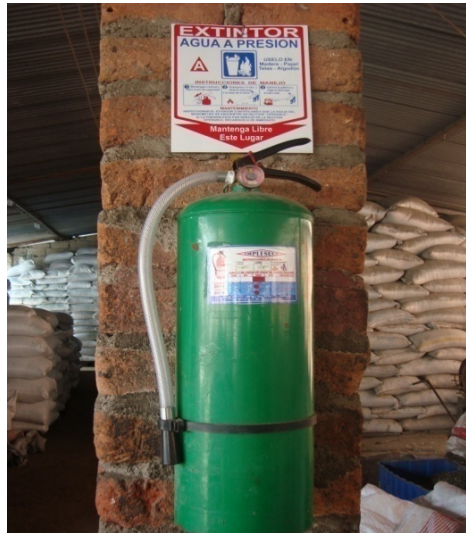
Foto 27. Extintor Agua a Presión
