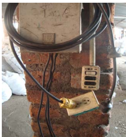
Foto 16. Instalaciones Eléctricas en mal estado
