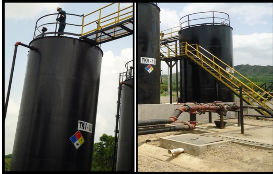
Figura 10. Juego de pasarela, barandela y escalera para acceso a tanque
