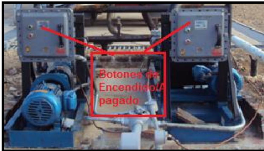
Imagen 13. Botones de Encendido/Apagado de las Bombas.
