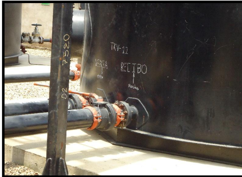
Imagen 7. Válvulas de entrada y salida de los tanques.
