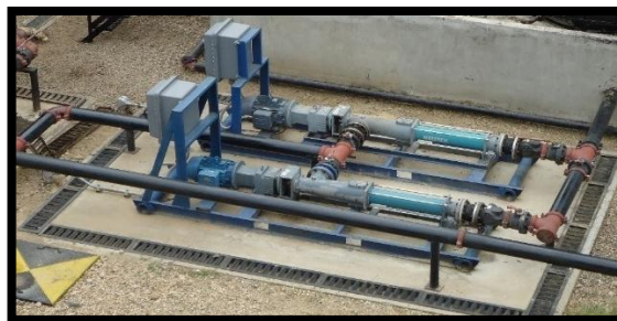
Figura 9. Placa en cemento para la bomba tornillo
