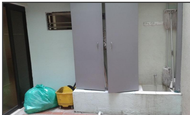
Figura 26. Pasillo aledaño a la planta eléctrica
