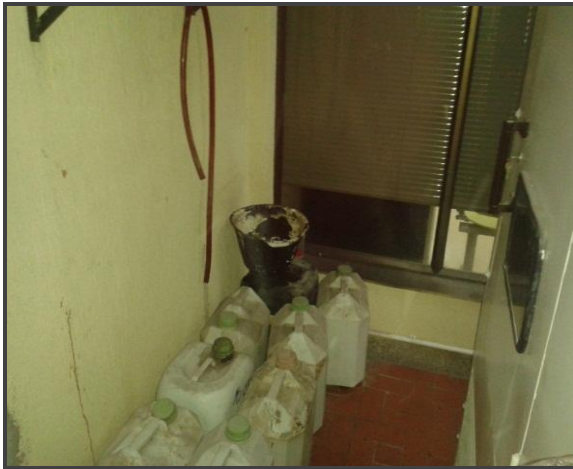
Figuras 24 y 25. Planta eléctrica ubicada en el sótano
