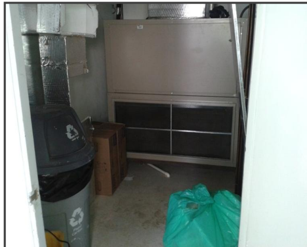
Figura 76. Almacenadora del aire acondicionado del Quinto Piso
