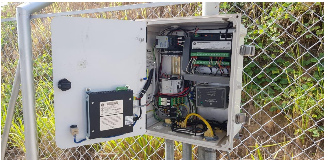
Figura N.12 – Gabinete controlador LWM 2.0.
