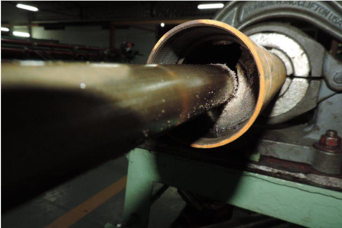
Figura N.19 – Obstrucción de libre recorrido de pistón en barril por arena.
