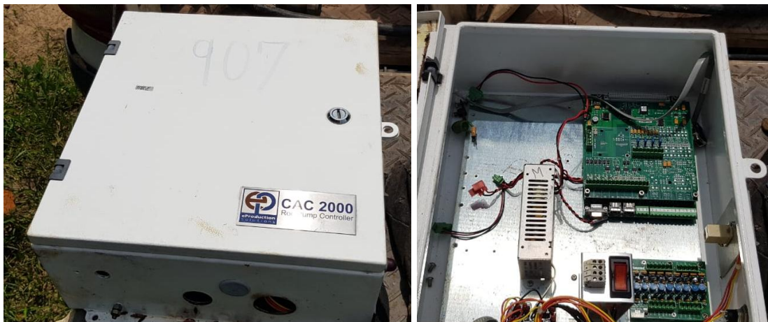
Figura N.9 – Gabinete controlador E-PIC.
