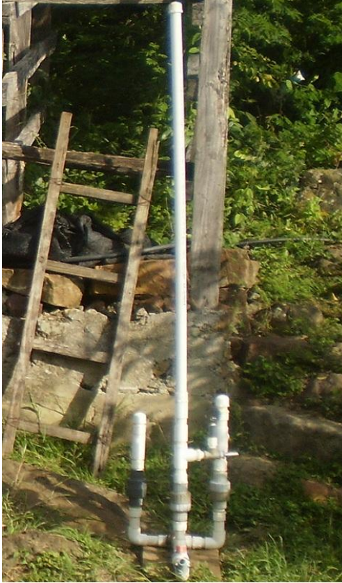
Figura 53. Bomba de ariete instalada en la Vereda Naranjal bajo.
