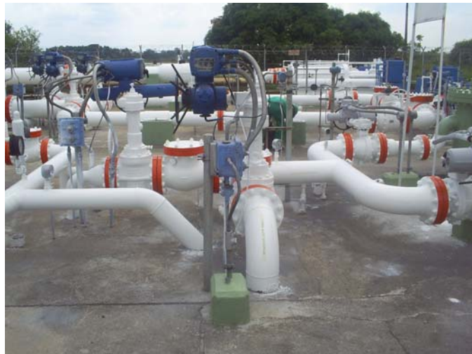
Figura 27. Válvula de bloqueo para el sistema de medición
