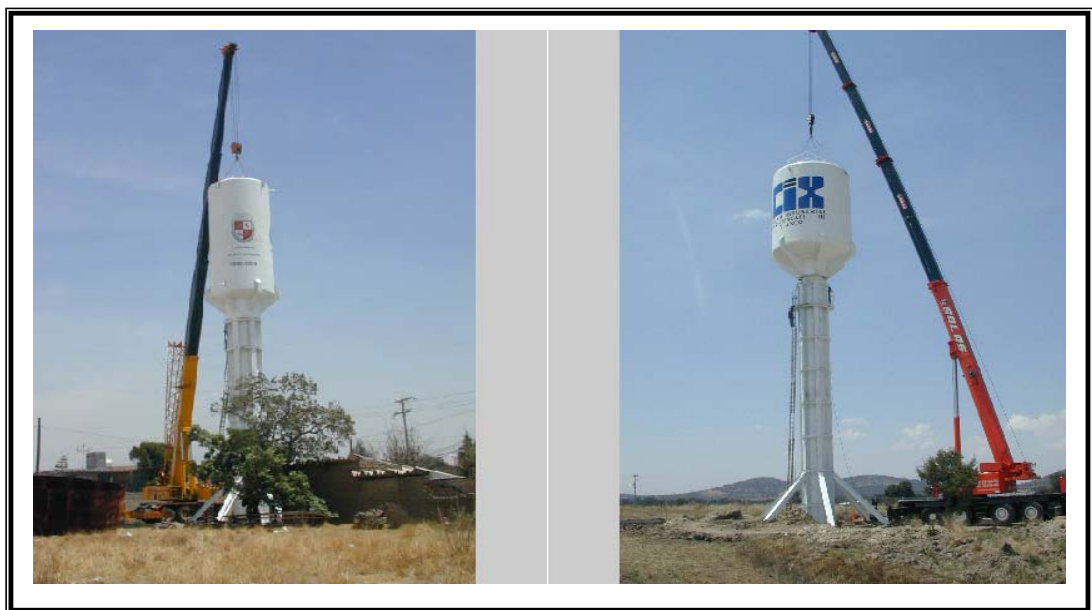
Figura 4. Tanques elevados unipolares
