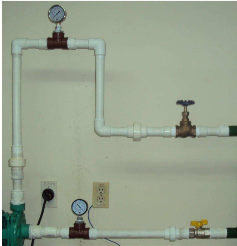
Figura 16. Sistema de tubería en el banco
