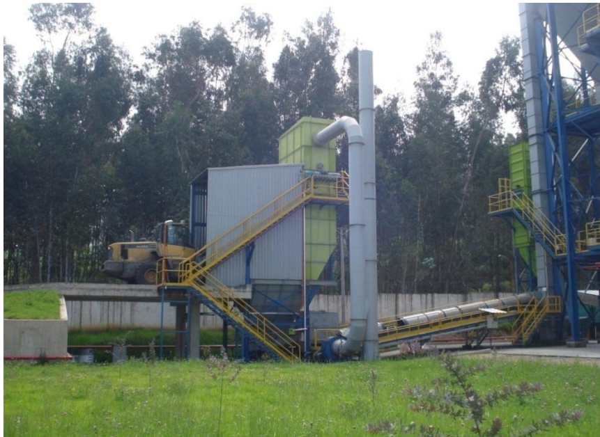
Figura 8. Alimentación de combustible.
