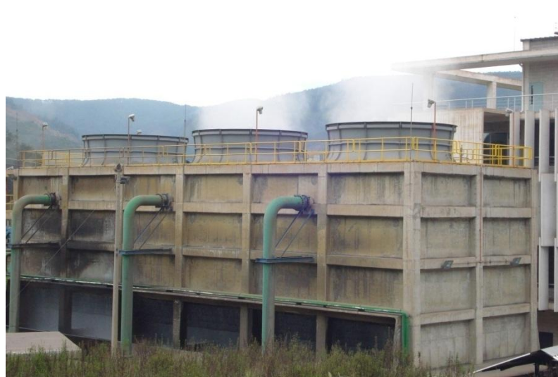
Figura 10. Torre de enfriamiento
