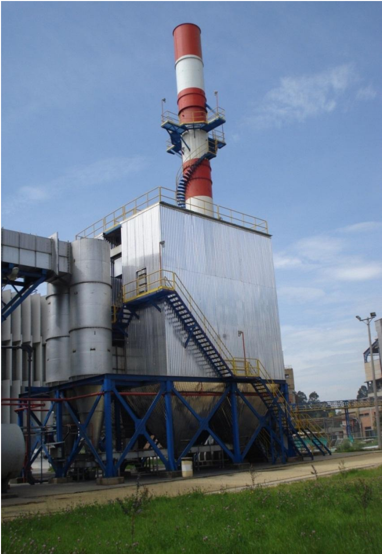
Figura 12. Filtro de mangas caldera.
