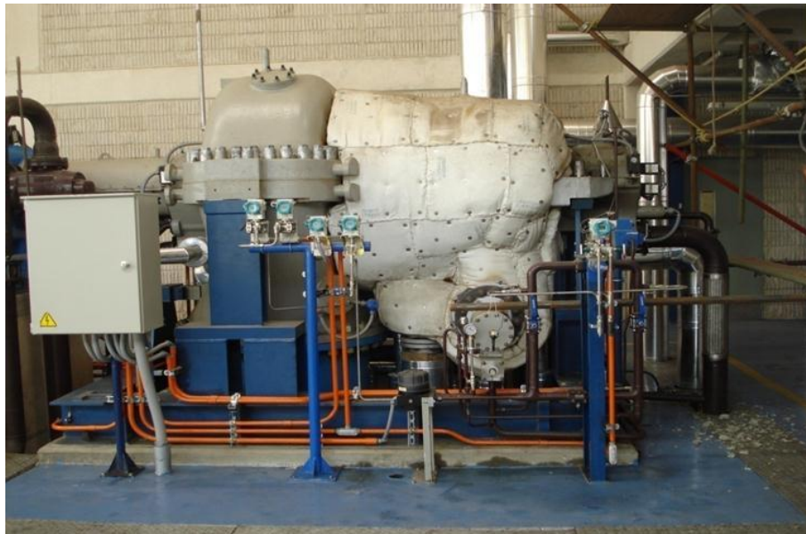
Figura 4. Turbina de vapor.
