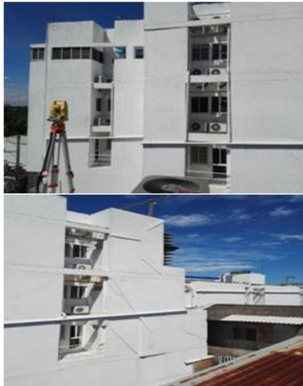
Figura 3. Edificación en estudio y visualización de grietas
