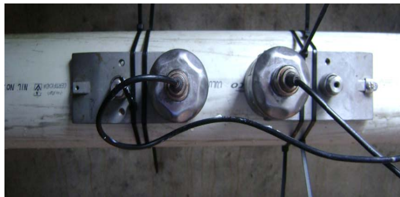
Figura 34. Ubicación de los sensores en la tubería con la distancia obtenida en el transmisor.
