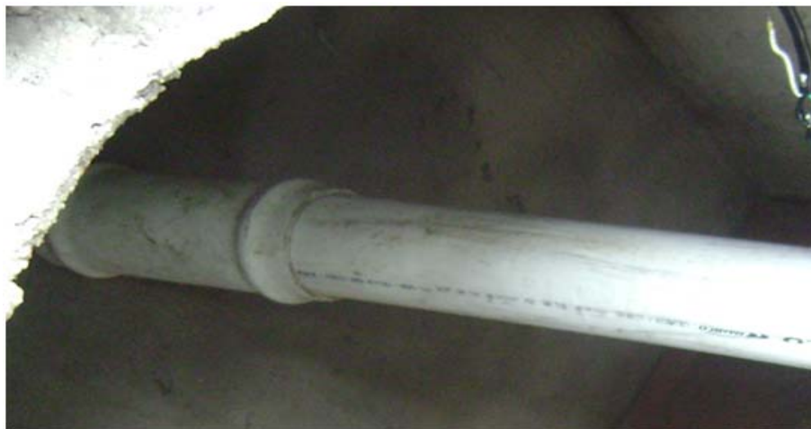
Figura 31. Tubería de macromedición tipo PVC 4", sector Ruitoque.
