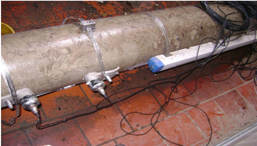
Figura 35. Montaje verificación de caudal en Anillo Vial.
