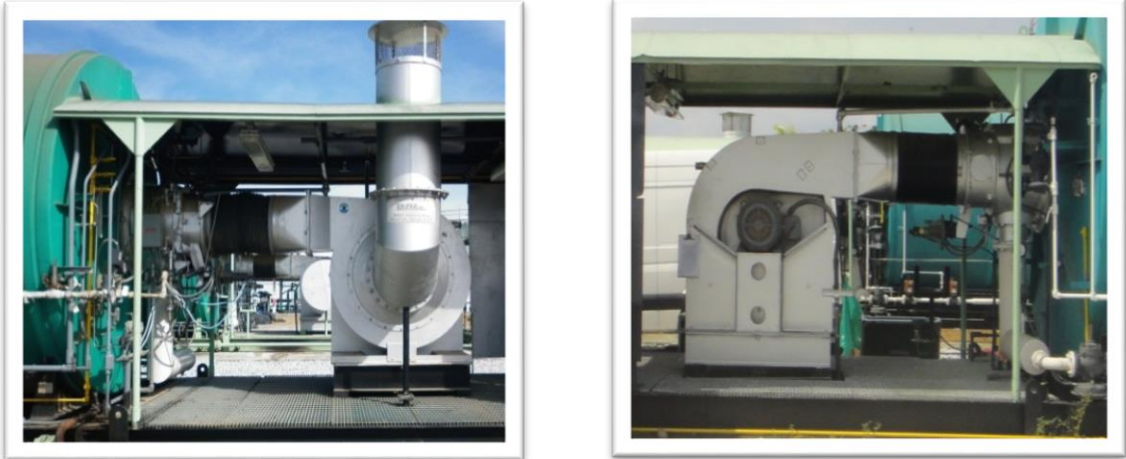
Figura 8. Quemador de Generador de Vapor
