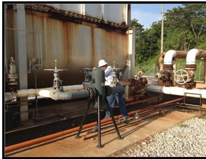
Figura 28. Instalación del separador a la salida del generador de vapor
