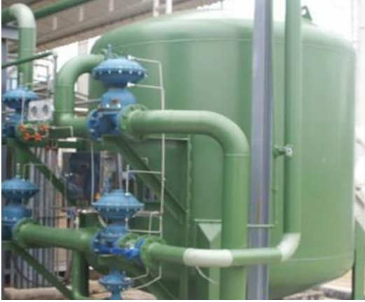
Figura 16. Filtros de Arena
