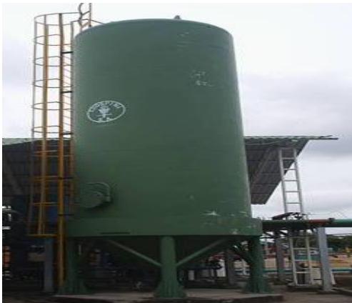
Figura 15. Tanque de Oxidación
