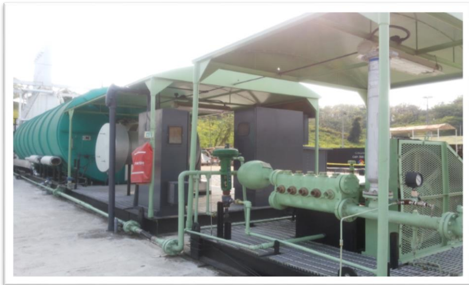
Figura 7. Generador de Vapor
