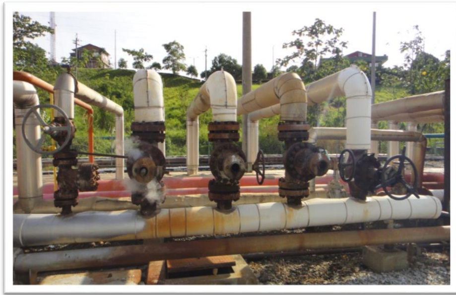
Figura 10. Manifold de inyección de vapor
