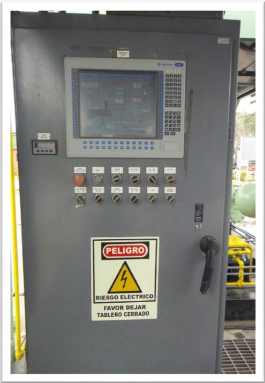
Figura 9. Tablero de control. Generador de vapor
