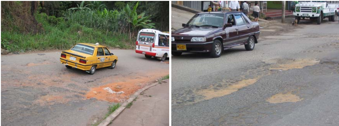
Figura 3- Estado actual de la carretera antigua a Floridablanca
