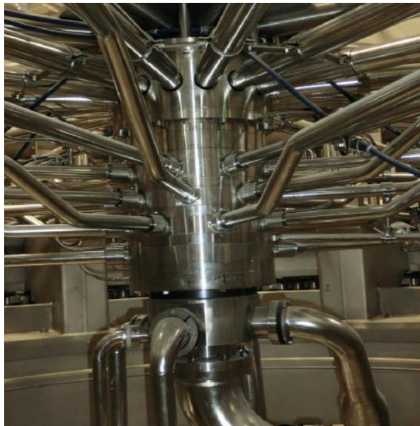
Ilustración 17. Distribuidor de producto
