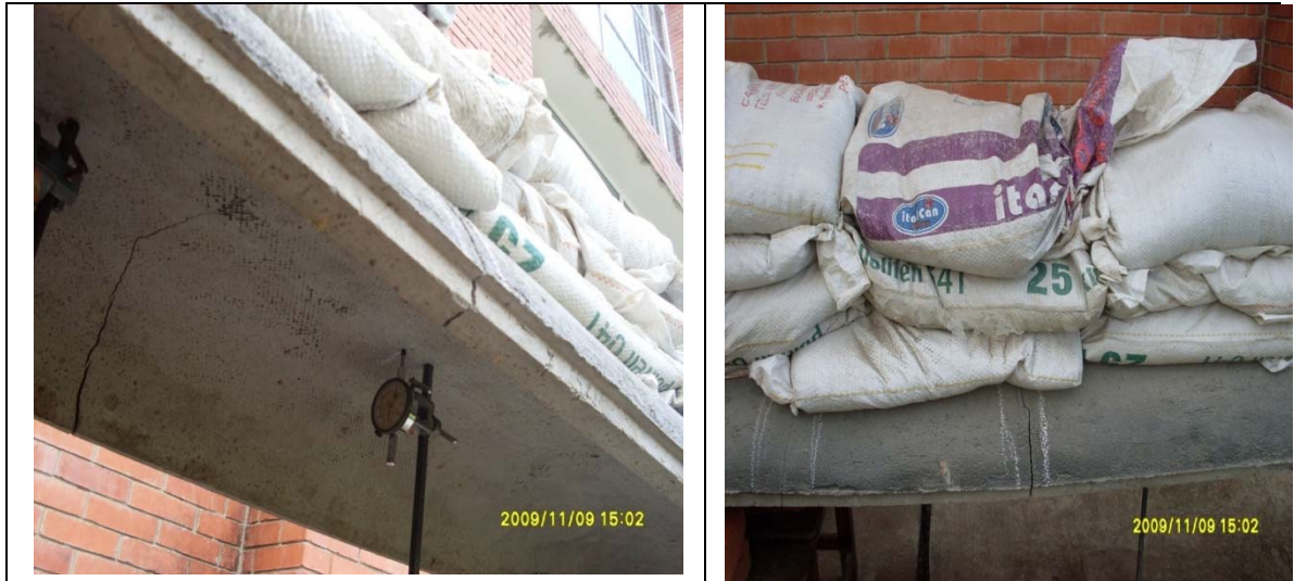
Fotografía 4.13 Grietas debido al tercer incremento de carga.
