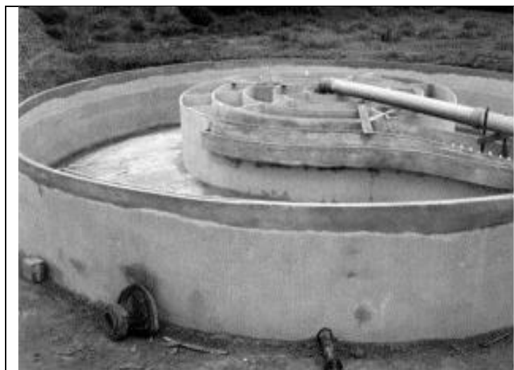
Fotografía 2.3. Tanque de Planta de Tratamiento
