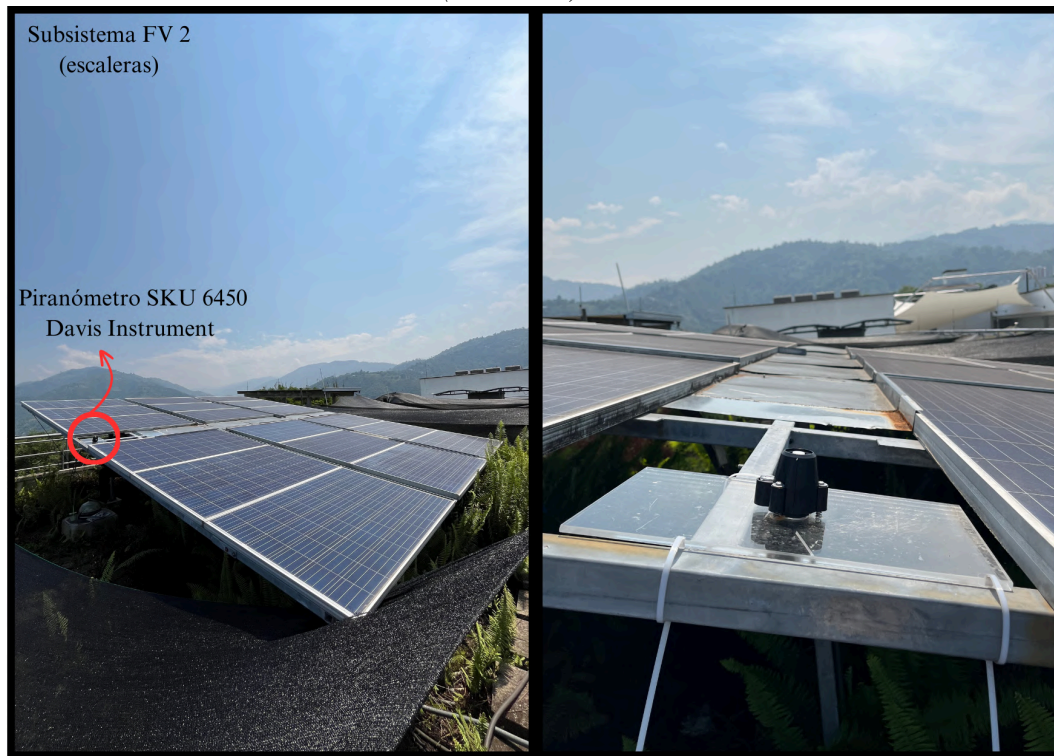
Figura 11. Piranómetro SKU 6450 subsistema FV 2 (escaleras)
