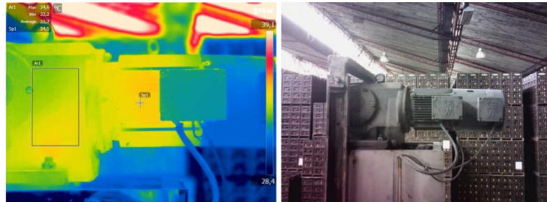
DEPALETIZADORA: MOTORREDUCTOR HORIZONTAL
