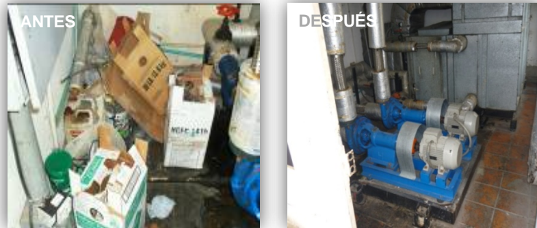
Foto 6. Cuarto máquinas piso 6
