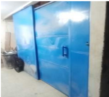
Elevador de carga
