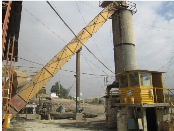
FIGURA 20. SILO Y ELEVADOR PRINCIPAL
