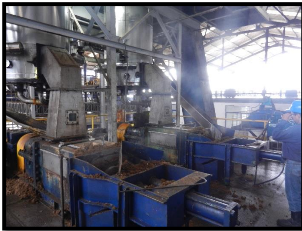
Figura 21. Digestores y prensas
