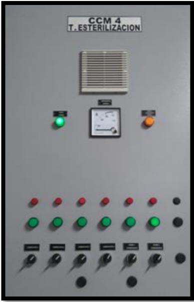
Figura 27. Control de Tanque de esterilización
