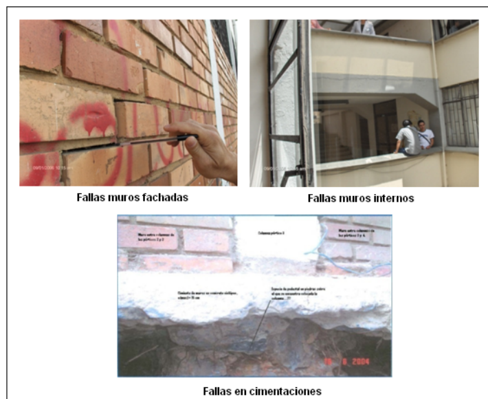
Figura 4. Fallas en la infraestructura de la sede UIS Barbosa
