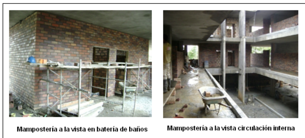
Figura 19. Registro fotográfico para la actividad de mampostería a la vista para el edificio de aulas
