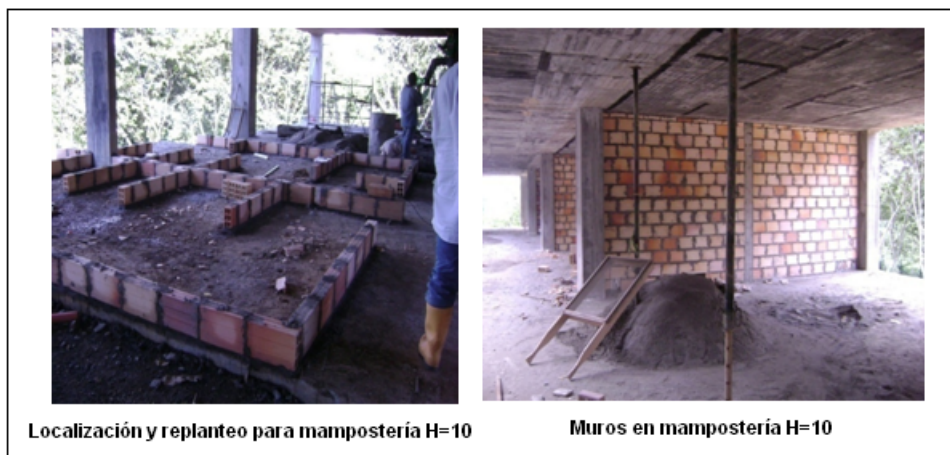
Figura 18. Registro fotográfico de la actividad de mampostería en ladrillo H=10 para el edificio de aulas
