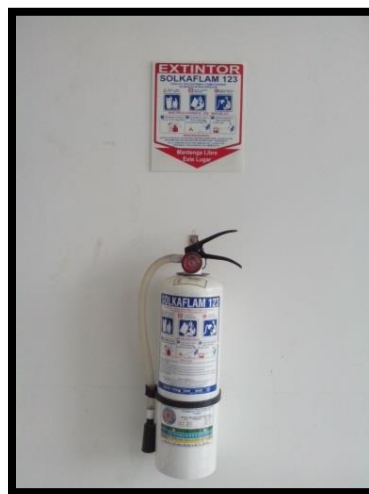
Ilustración 13: Disposición, instalación y recarga de extintores.
