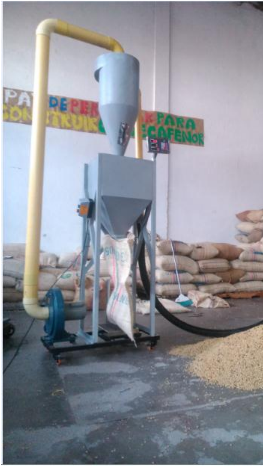
Figura 59: Sistema de transporte neumático en funcionamiento.
