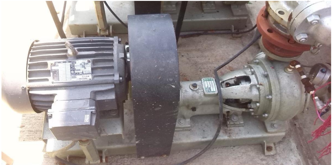
Figura 26. Motor y bomba de lodos florentinos.
