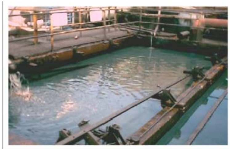
Figura 12. Piscina principal separador SE-3010
