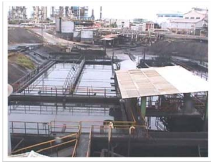
Figura 14. Piscinas colectoras del separador 3030.
