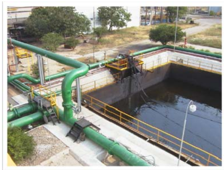
Figura 30. Piscina de carga BA-4001 con el desnatador W-4003
