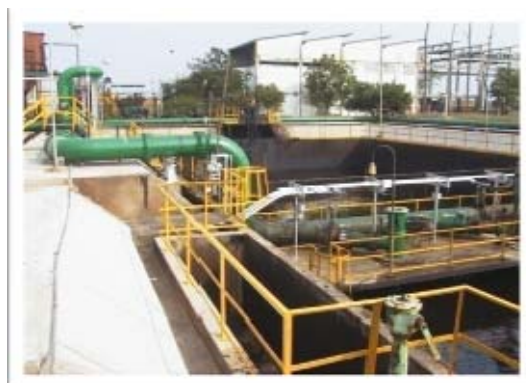
Figura 25. En la piscina de carga BA-4001 ocurre la Homogenización
