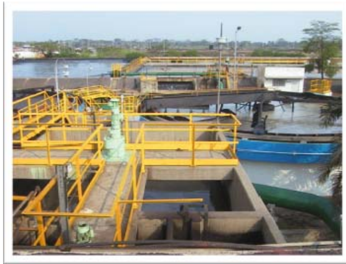
Figura 27. Trenes donde ocurre la coagulación - floculación
