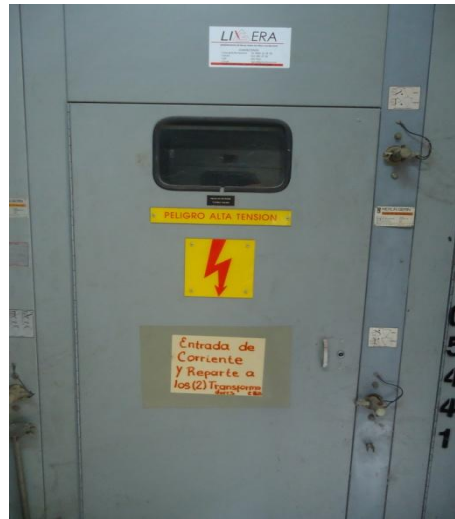
FIGURA 15. Fotografía Celda de Seccionador Tripolar (Transformador 400 kVA).
