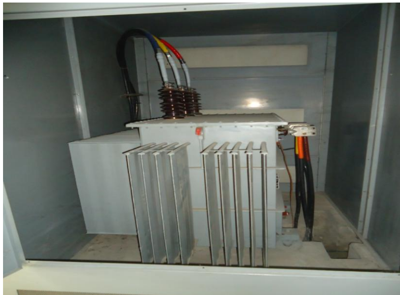
FIGURA 17. Fotografía Transformador 400 kVA.
