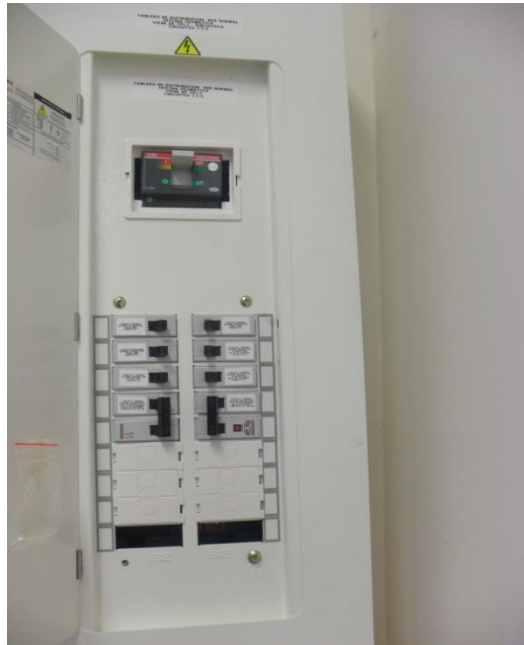
FIGURA 26. Fotografía del tablero TN.
