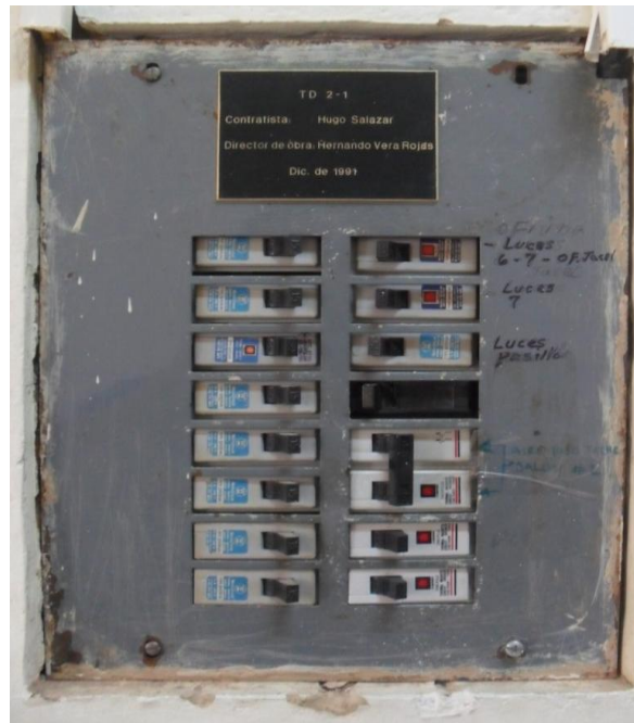
FIGURA 23. Fotografía del tablero TD2-1
