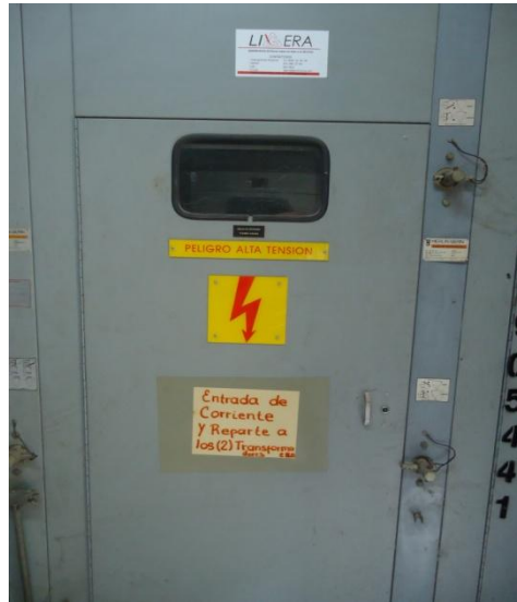
FIGURA 13. Fotografía Celda de entrada y doble salida.
