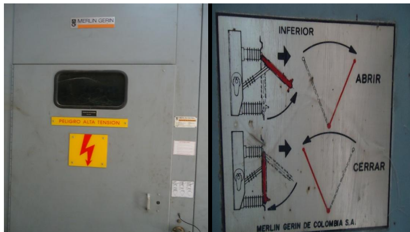
FIGURA 14. Fotografía Celda de Seccionador Tripolar (Transformador 150 kVA).
