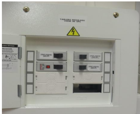
FIGURA 27. Fotografía del tablero TR
