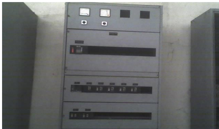
FIGURA 19. Fotografía Tablero UA.
