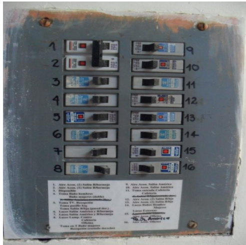
FIGURA 24. Fotografía del tablero TD2-1
