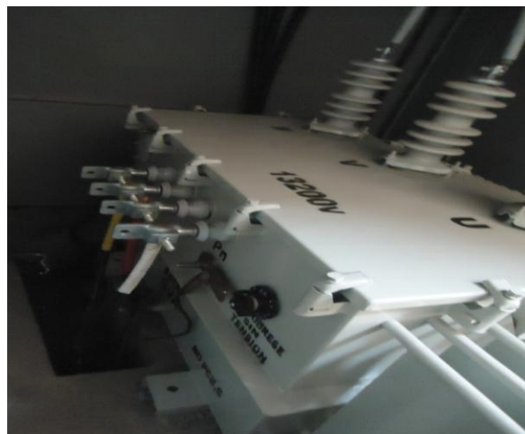
FIGURA 16. Fotografía Transformador 150 kVA.
