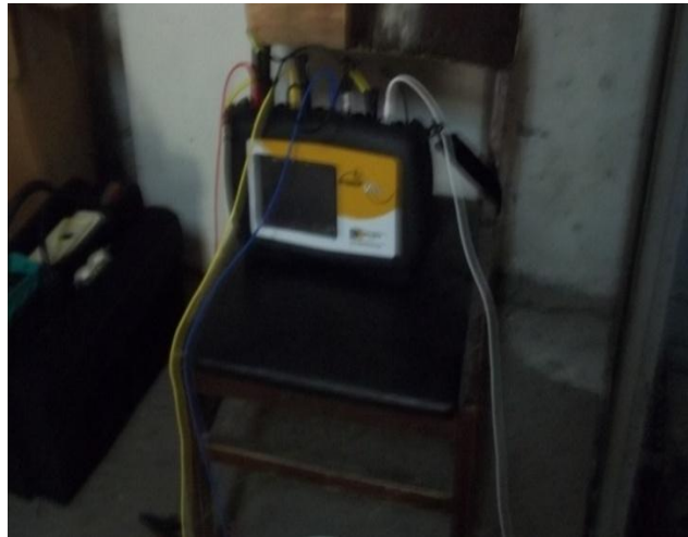
FIGURA 66. Fotografía montaje del analizador de redes, transformador de 400 kVA.
