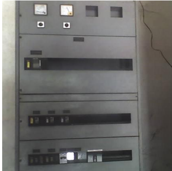
FIGURA 18. Fotografía Tablero TG-S/E.
