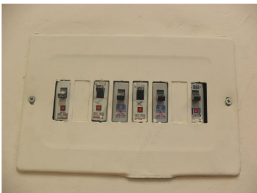
FIGURA 28. Fotografía del tablero TI
