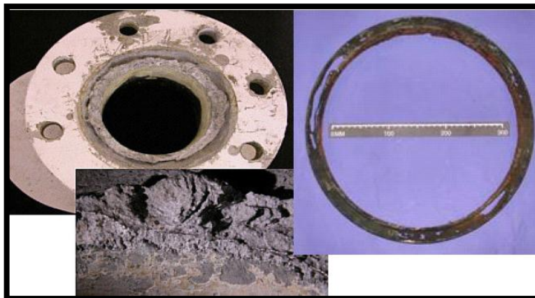
Figura 34. Consecuencias por corrosión en bridas
