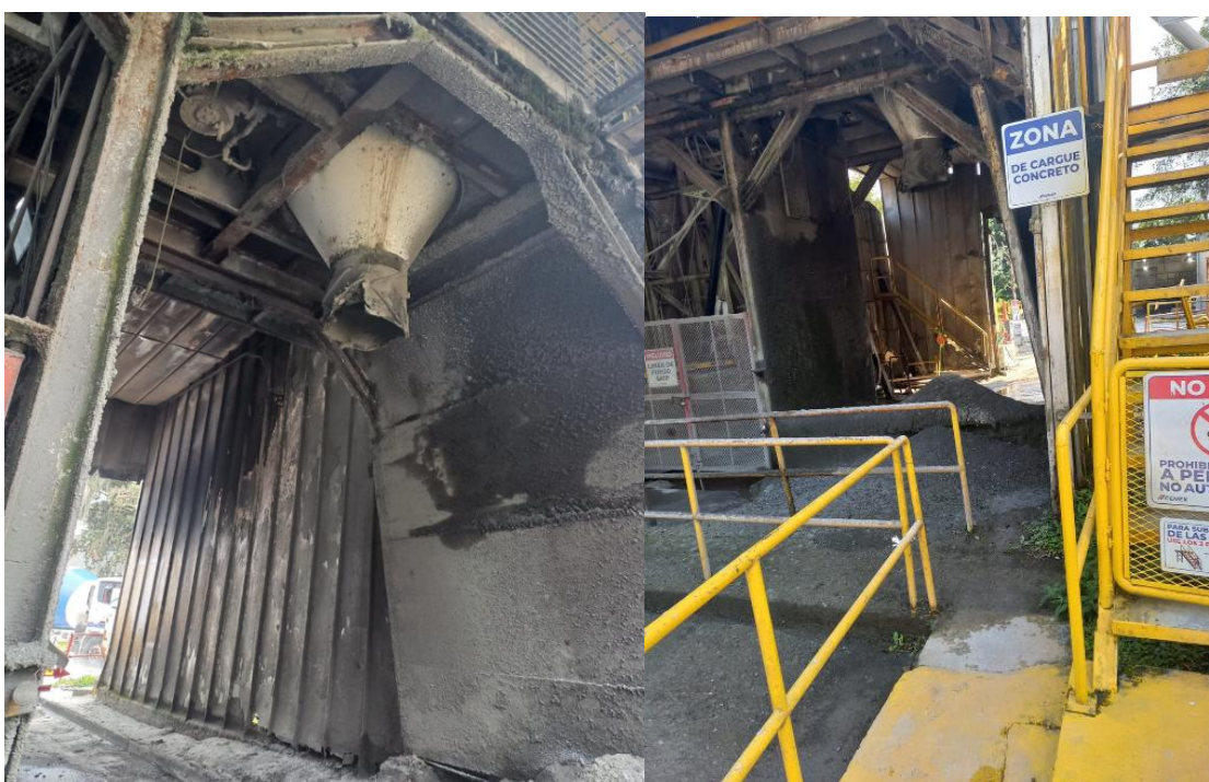
Figura 37 Chispeo generado en el punto de transferencia
