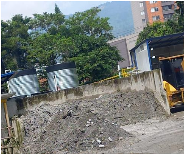
Figura 22 Evidencia de escombros presentes en la planta
