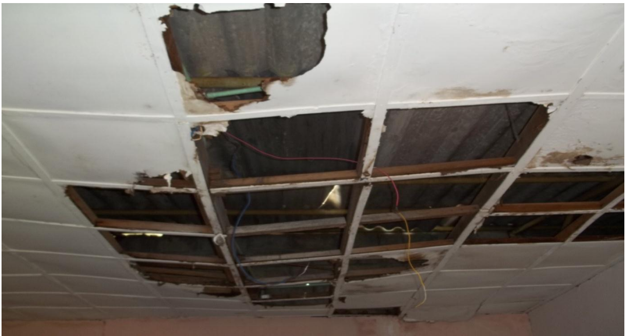
Foto 4. Estado del techo. Salón deshabilitado.
