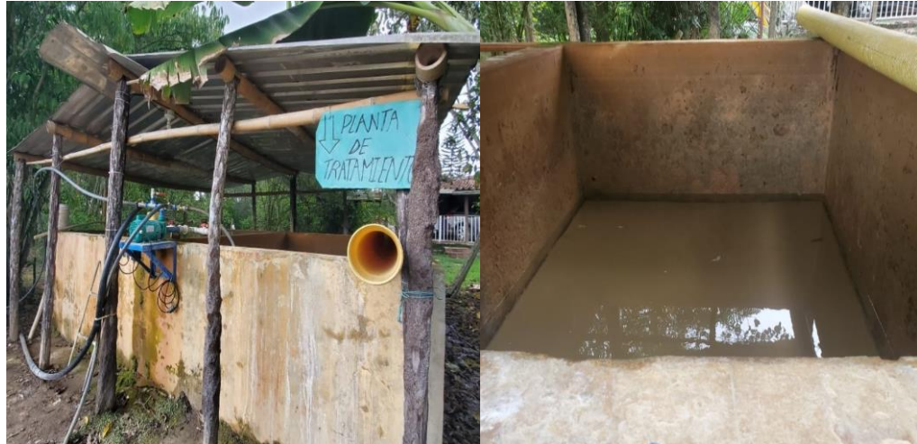
Figura 24. Planta de tratamiento
