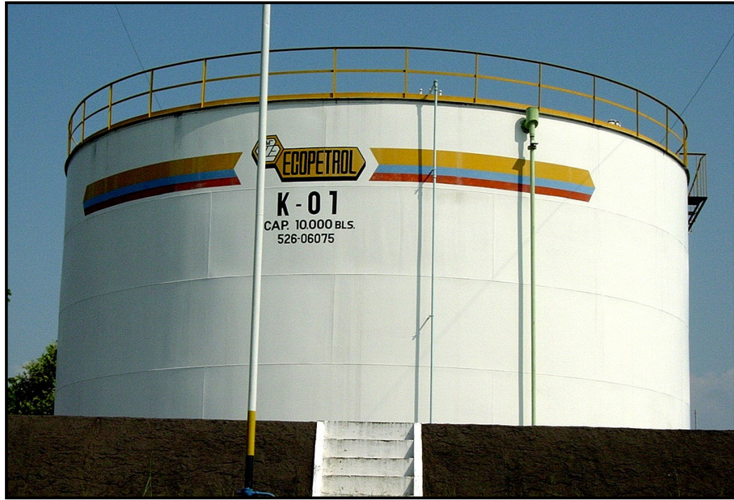
Figura 7.24 Tanque de Reposo TK-01
