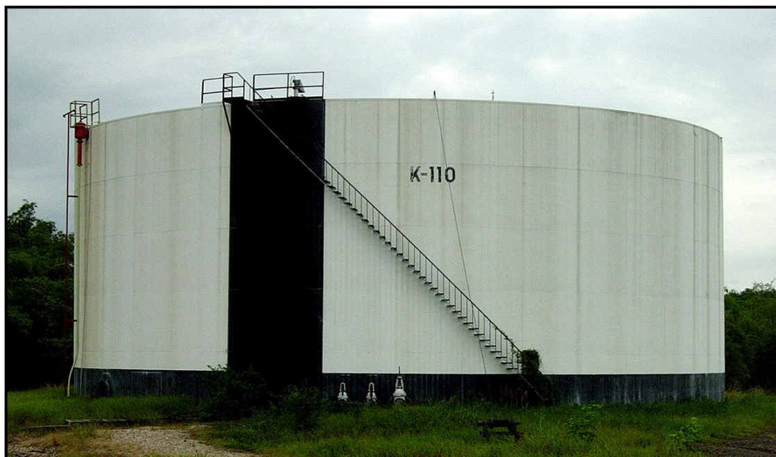
Figura 7.30 Tanque de Fiscalización TK- 110
