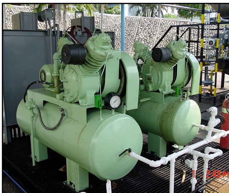
Figura 7.40 Compresores para el Sistema de Aire de Instrumentos
