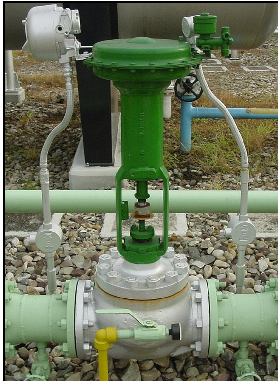
Figura 6.6 Válvula de control tipo globo
