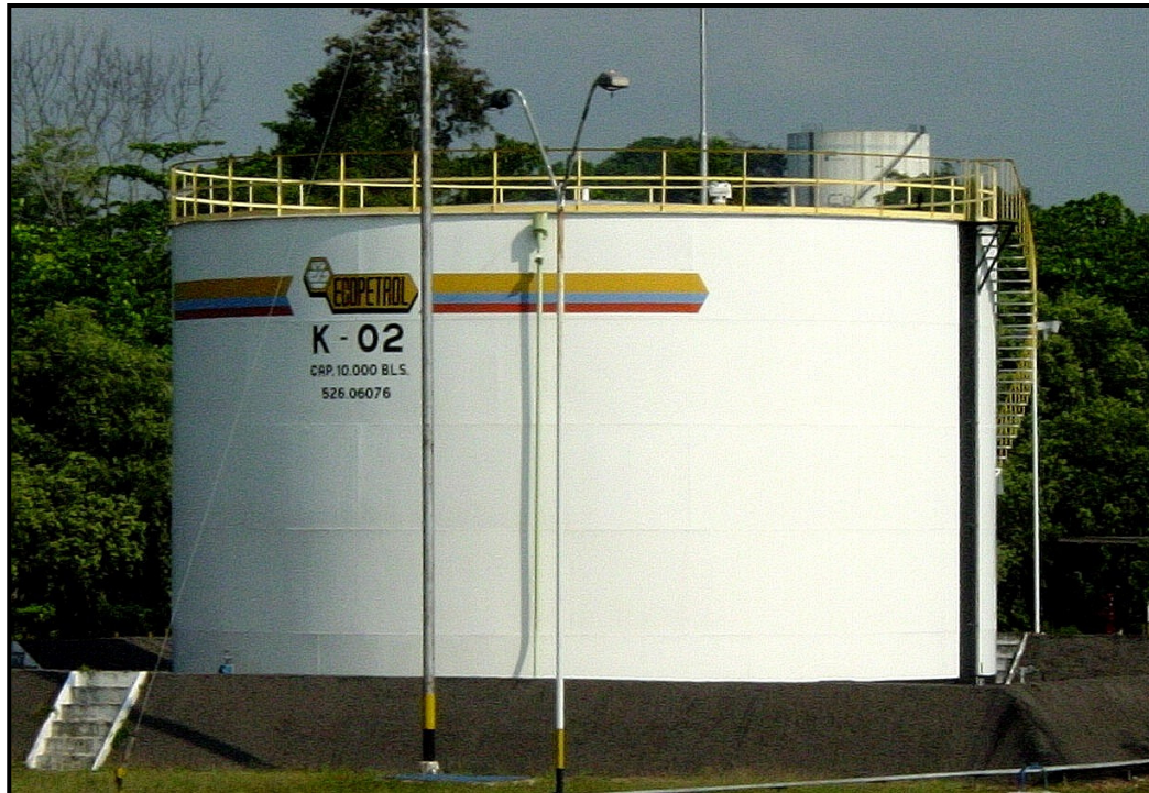
Figura 7.25 Tanque de Reposo TK-02
