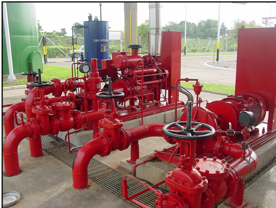
Figura 7.16 Bombas Sistema Contra incendio
