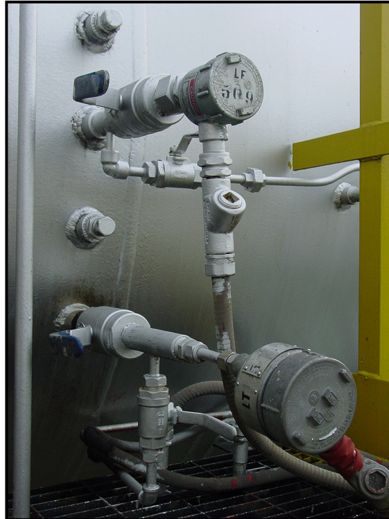
Figura 6.4 Elementos de medida - Sensores eléctricos
