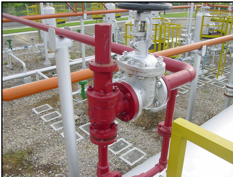
Figura 6.11 Sistema de válvula de seguridad
