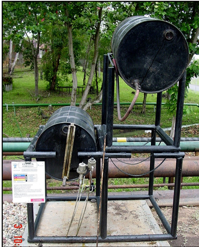
Figura 7.19 Sistema de Inyección de Químicos
