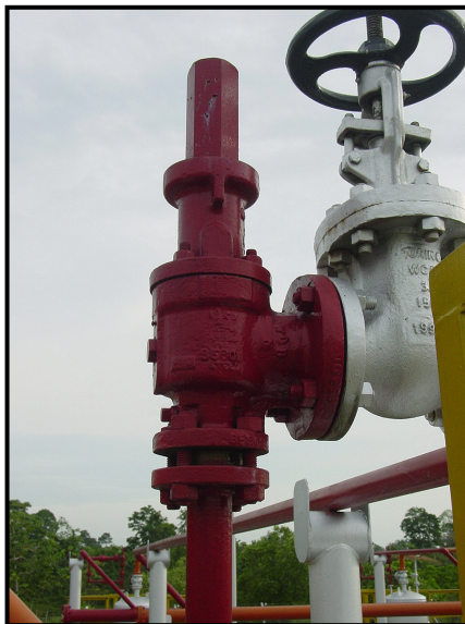
Figura 6.3 Sistema de válvula de seguridad
