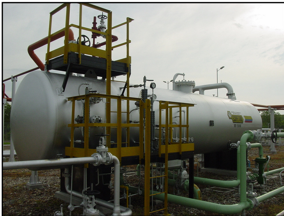
Figura 7.8 Entrada de crudo al separador
