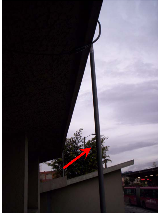
Figura 19. Antena Omni instalada en Portal de la 80
