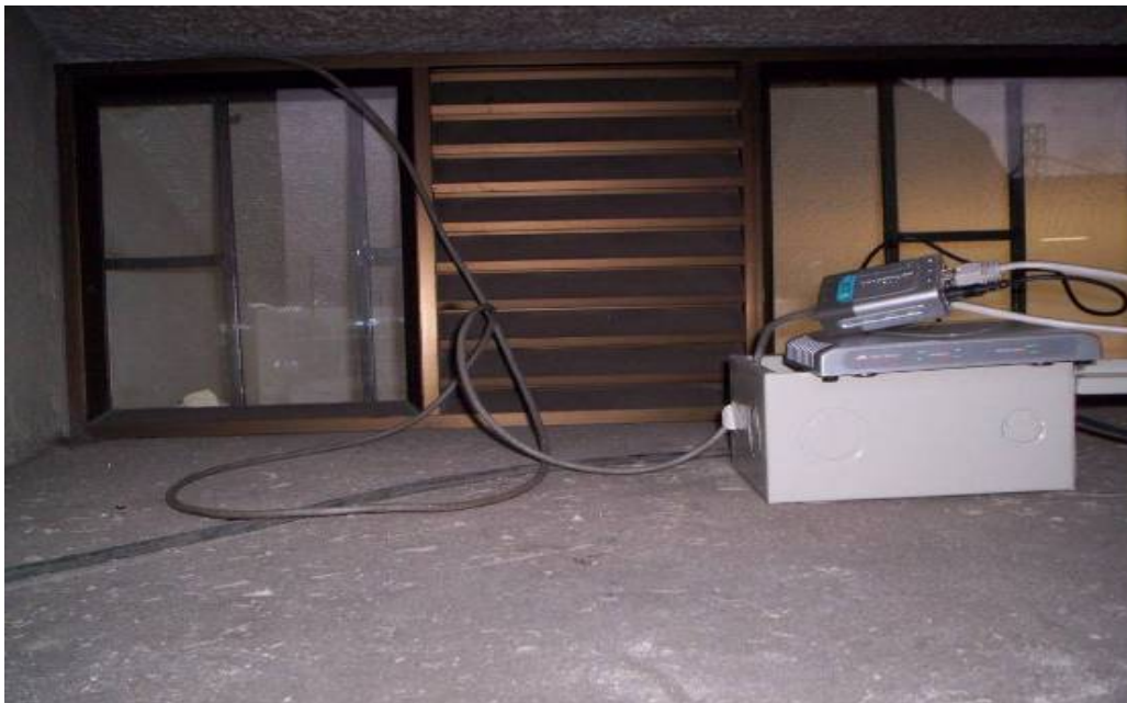
Figura 18. Acces Point 7400 de Allied Telesyn junto con el PoE de Dlink instalados en Portal de la 80
