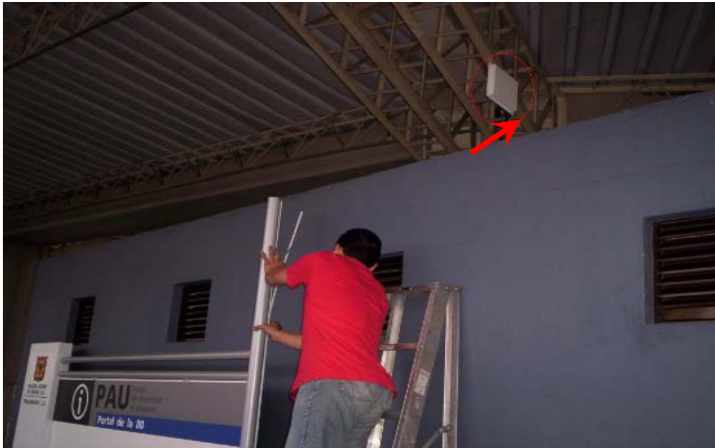
Figura 17. Antena Panel instalada en Portal de la 80
