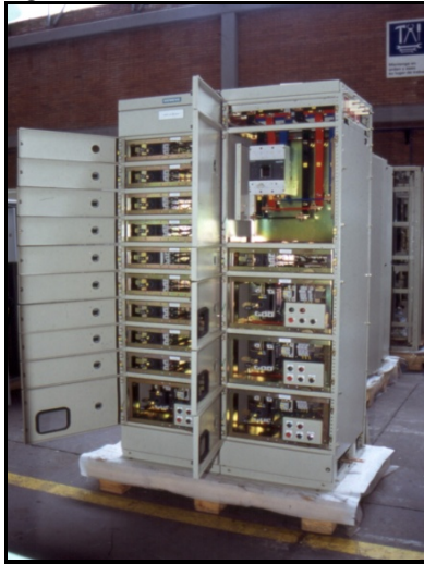
Figura 3.13. Celda 8PU CCM
