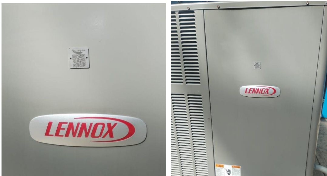
Figura 3. Placa instalada en el activo:
