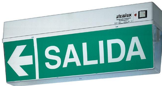
Figura 52. Señalización de salida
