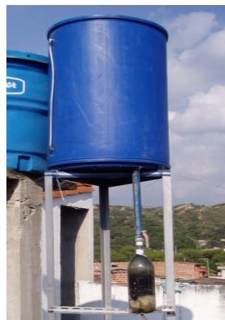
B. Tanque de almacenamiento
