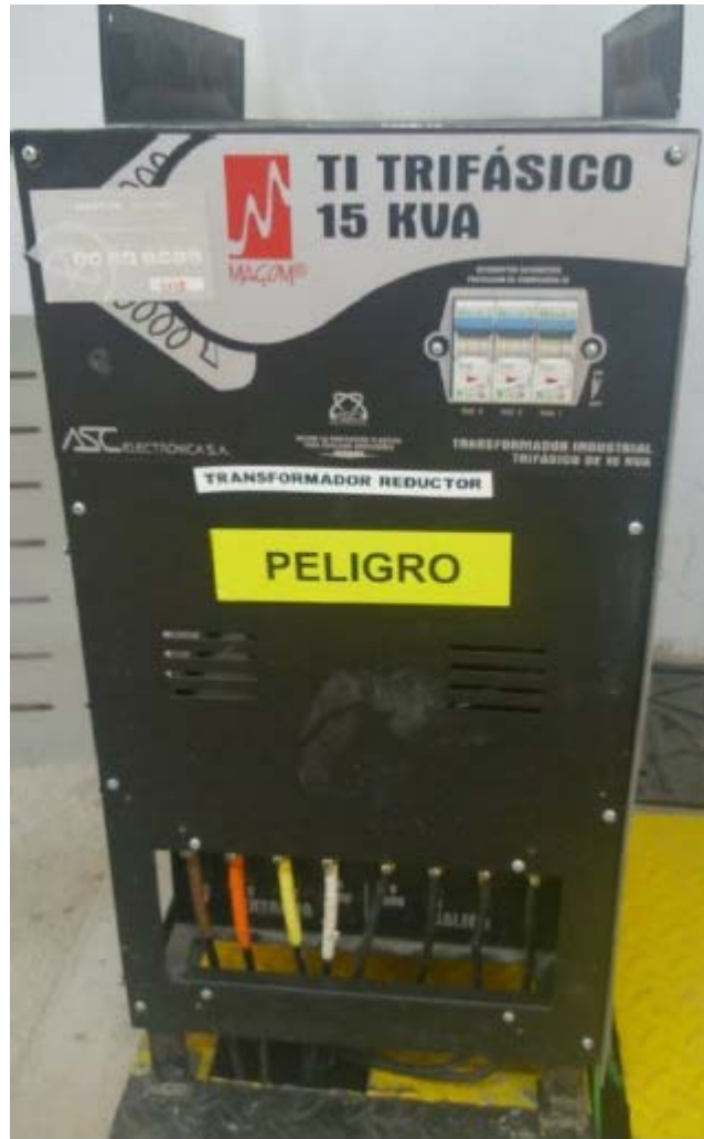
Figura 7. Transformador para las unidades manejadoras de aire acondicionado
