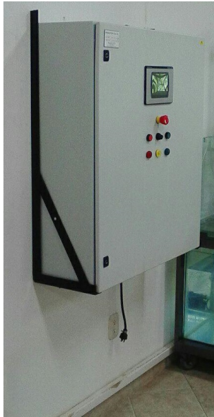
Figura15: Tablero de control fijo en la pared
