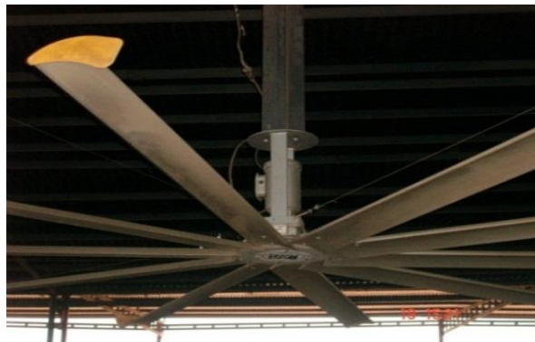
Figura 14. Ventilador marca Big Ass Fans.
