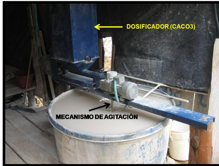
Foto No. 6. Sistema de dosificación
