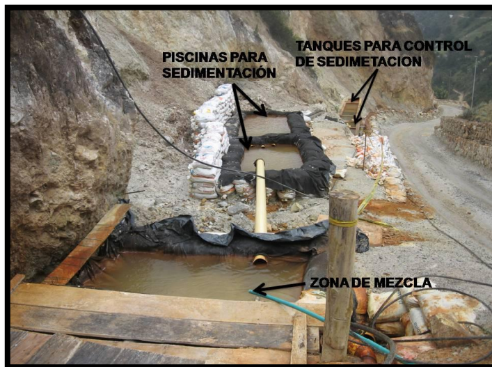
Foto No.7. Sistema de piscinas intercomunicadas para el manejo del DAM
