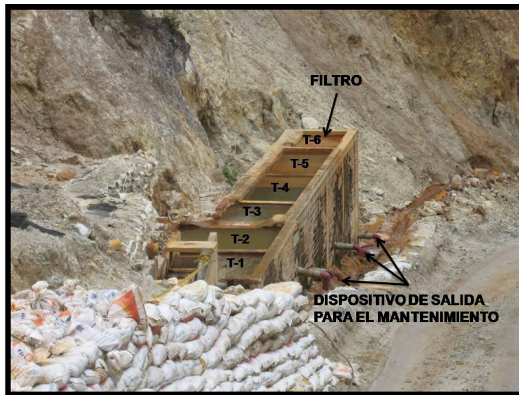
Foto No. 8. Sistema de tanques para el manejo del DAM
