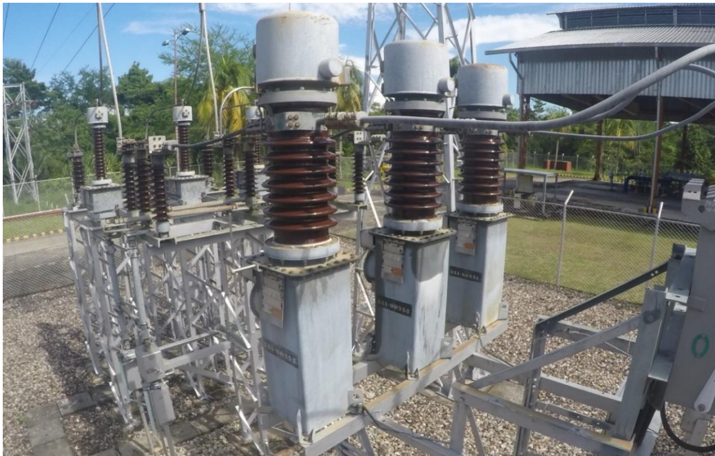
Figura 25. Transformadores de corriente (CT's)
