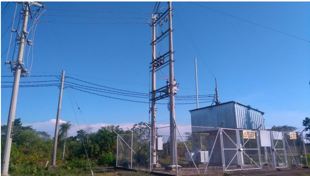
Figura 10. Subestación de distribución tipo.
