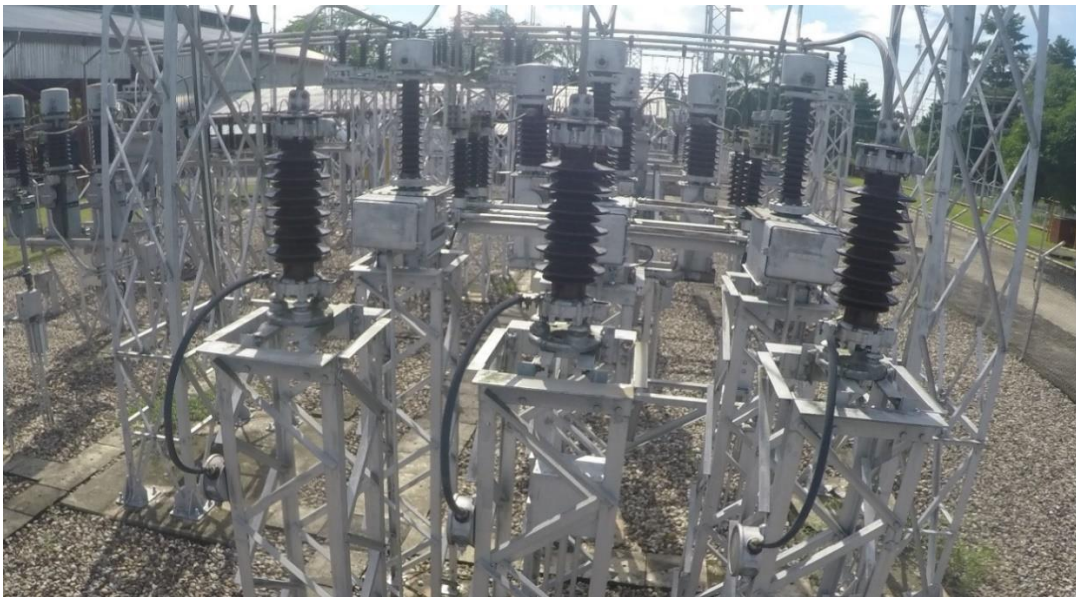
Figura 17. Dispositivo de protección contra Sobretensiones (DPS).
