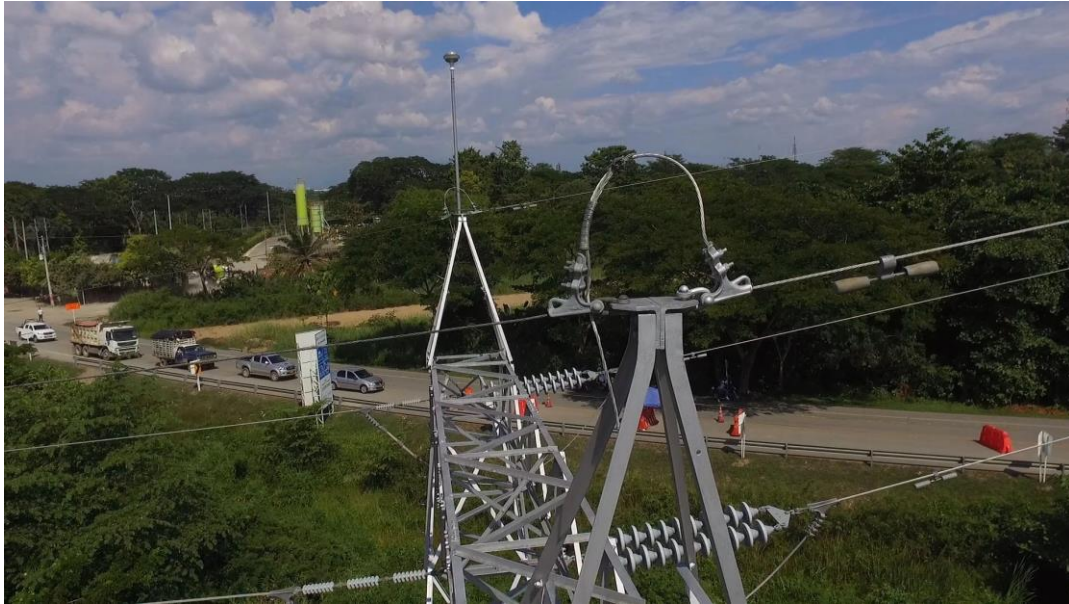
Figura 14. Cable de guarda.
