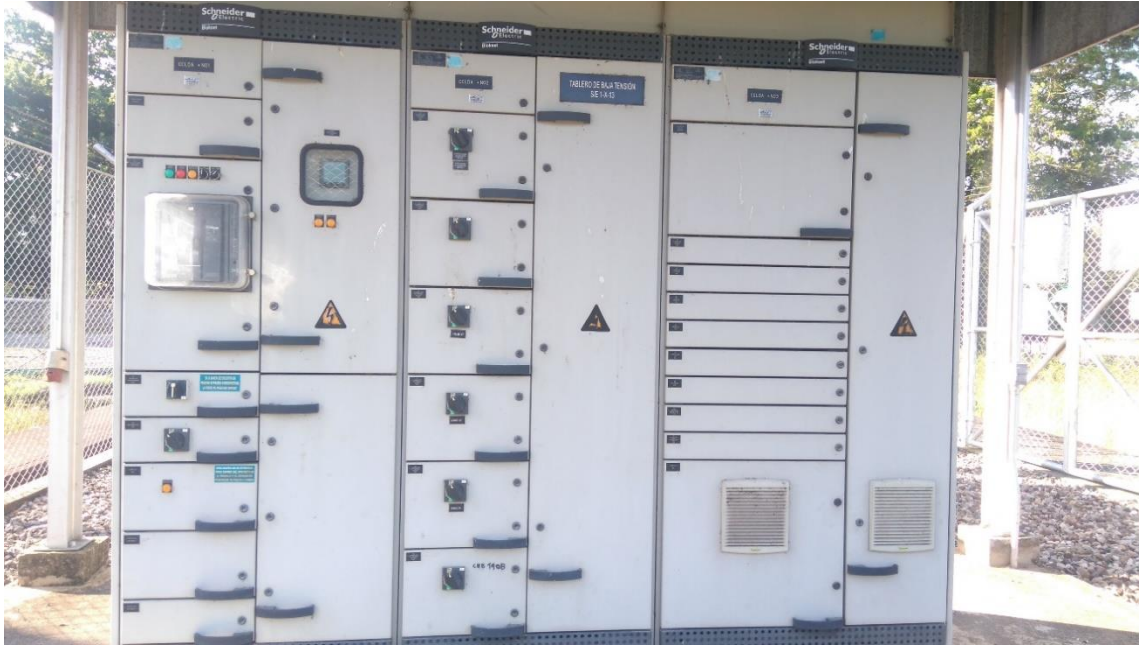
Figura 27. CCM (Centro control de motores) o tableros de distribución.
