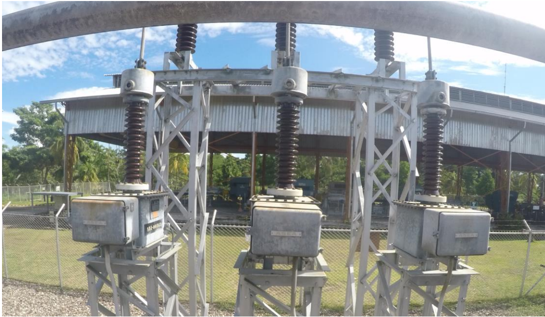
Figura 24. Transformadores de potencial (PT's)
