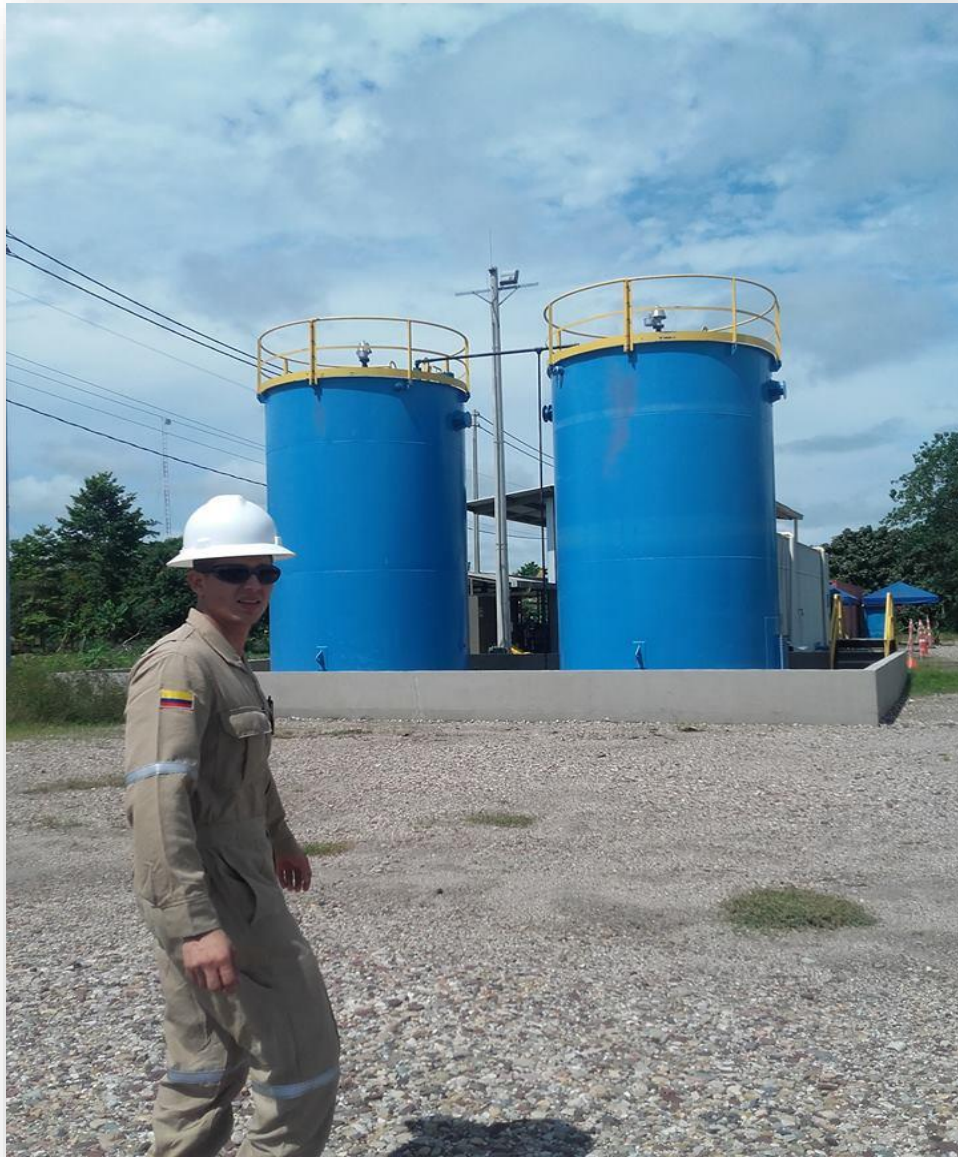
Figura 4. Tanques de almacenamiento de agua
