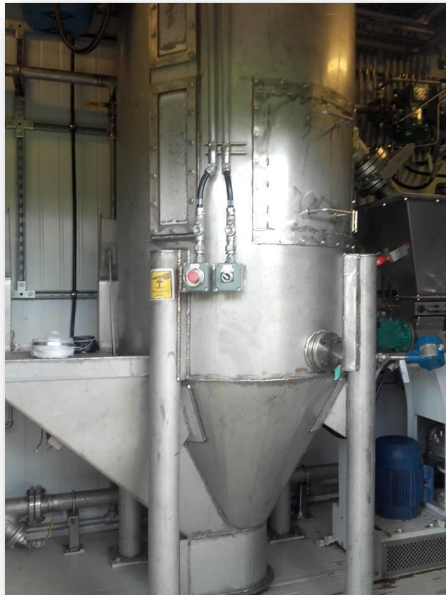
Figura 7. Silo de polímero seco
