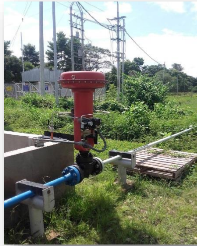
Figura 5. Bomba de suministro de agua
