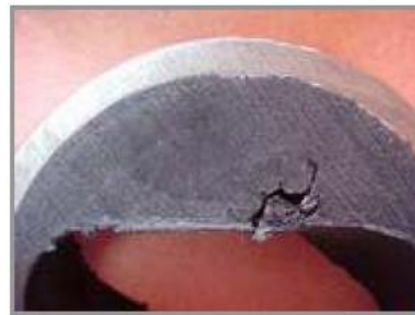
2- Comienzo del desprendimiento del elastómero, debido a la rigidez del mismo
