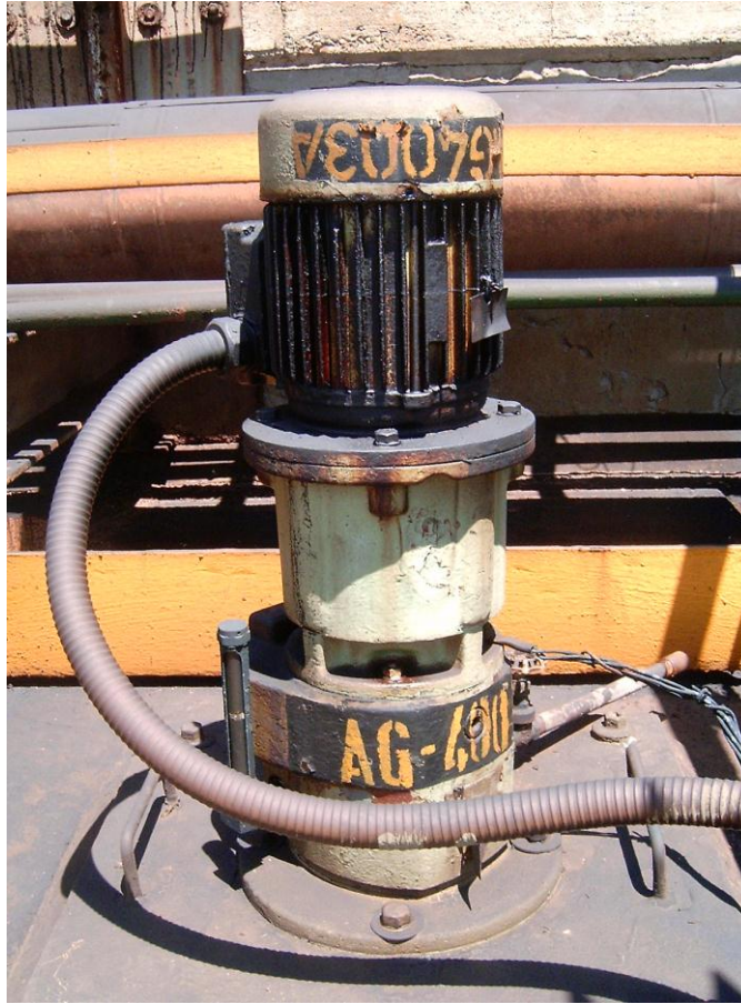
Figura 30. Agitador operando en planta.
