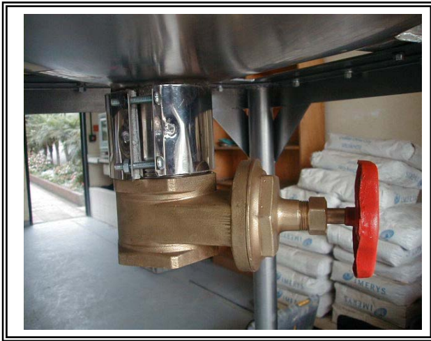
Figura D5 al anexo No. 4 Válvula de salida del reactor
