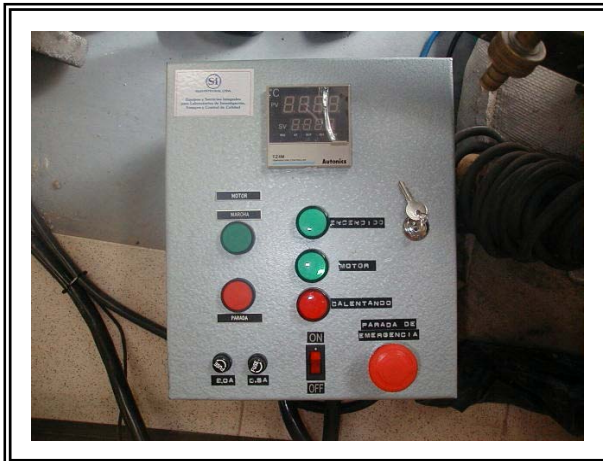
Figura D6 al anexo No. 4 Panel de Control
