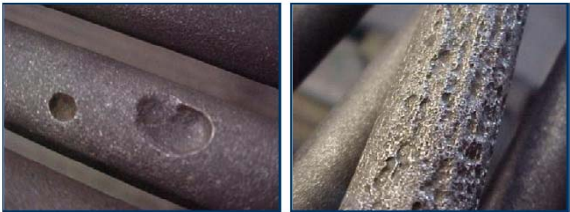
Figura 5. Corrosión localizada en ambientes acuosos con CO_2 (Formación picadura (izquierda), formación ataque de mesa (derecha))
